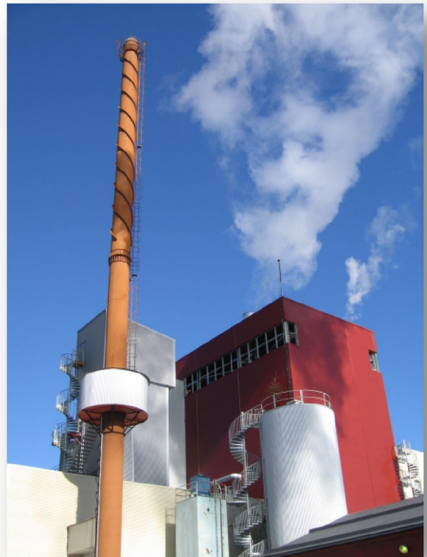
Bildet viser Bio-EI-anlegget.
